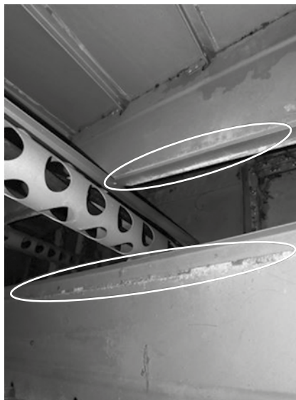
Рис. 7. Вид профиля нервюры № 1 киля (сверху) с коррозионным поражением окантовочного профиля
